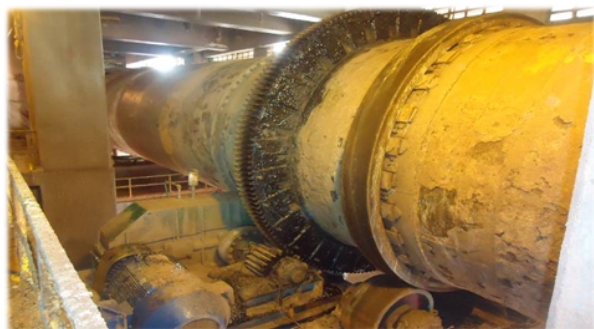
Figura 8: Tambor rotativo TR-401. Planta de NPK; Complejo Petroquímico Morón.
