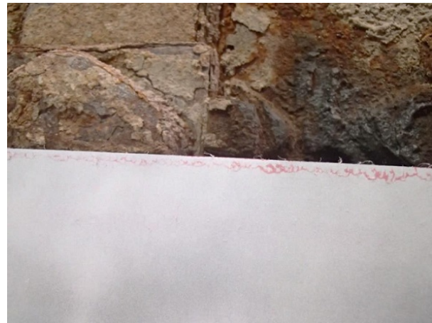
Figura 1: Formación de grieta sobre llanta de TR-401, comenzando en una de las caras
